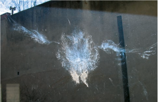
Aufprallspuren einer Taube.
